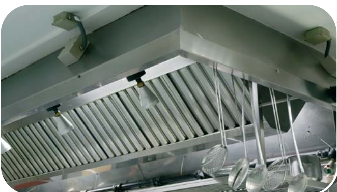
Cocina central Campana con filtros y plenum
